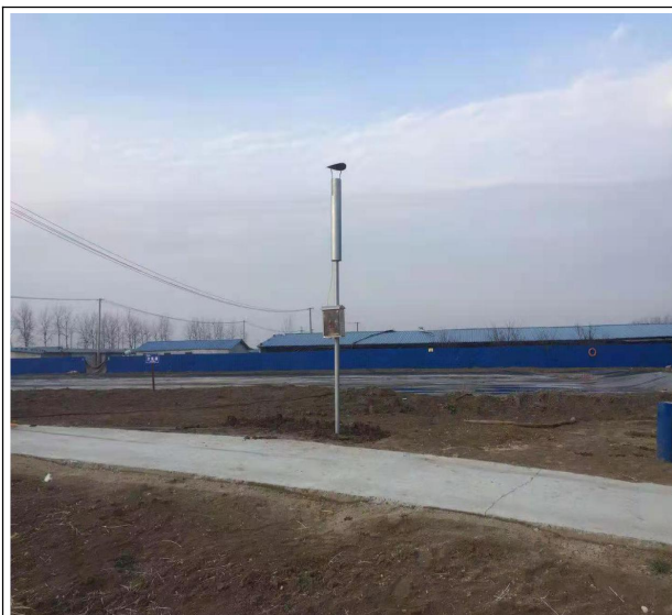
沼气燃烧火炬、道路硬化
