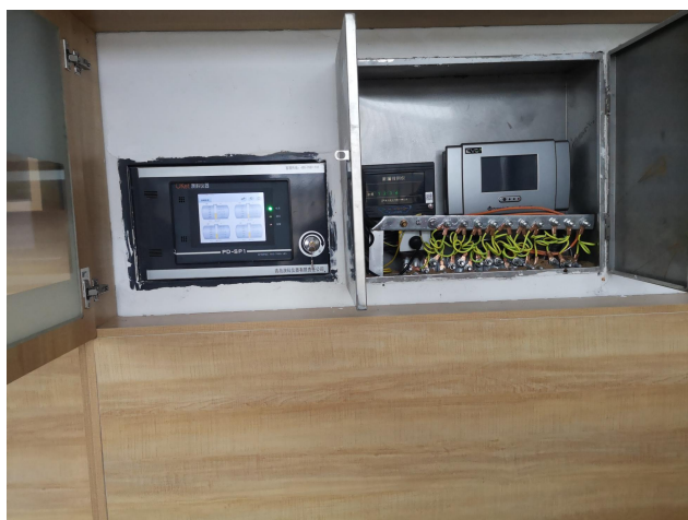
液位仪及泄露监控装置
