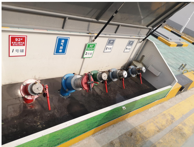
油气回收装置
