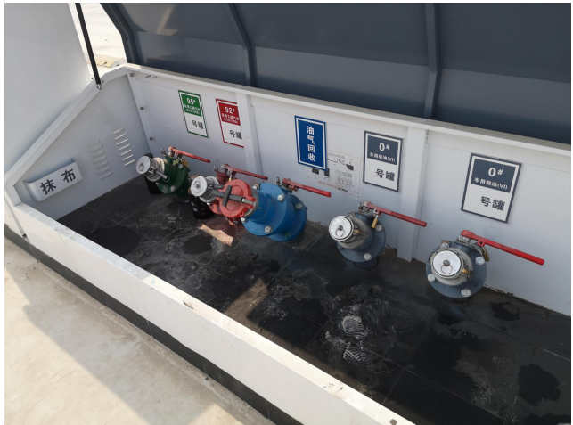
油气回收装置
