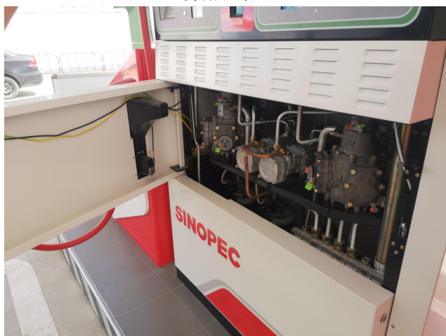
油气回收装置
