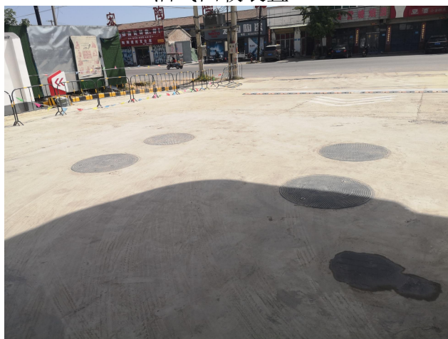
沉淀池及水封井
