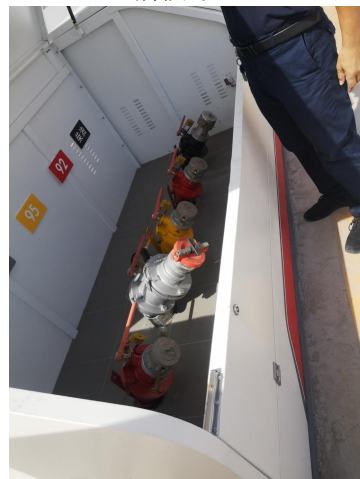
油气回收装置
